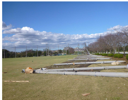
倒壊したネットの支柱（千葉県市原市） （10/13 撮影 気象庁職員）
